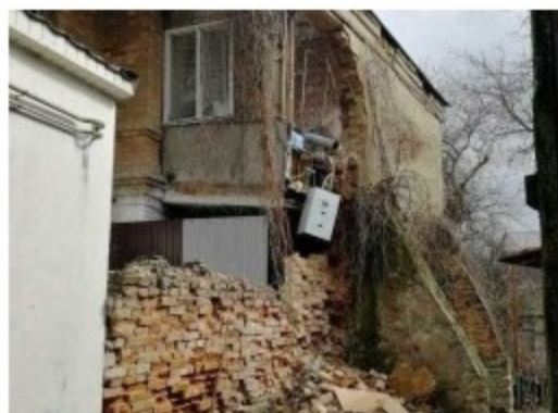
В Эссентуках обрушилась стена многоквартирного дома
